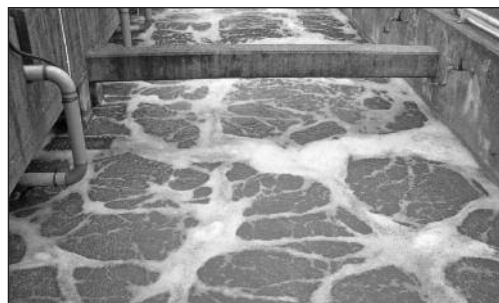
Figura 4 Bacia de IFAS aerada
