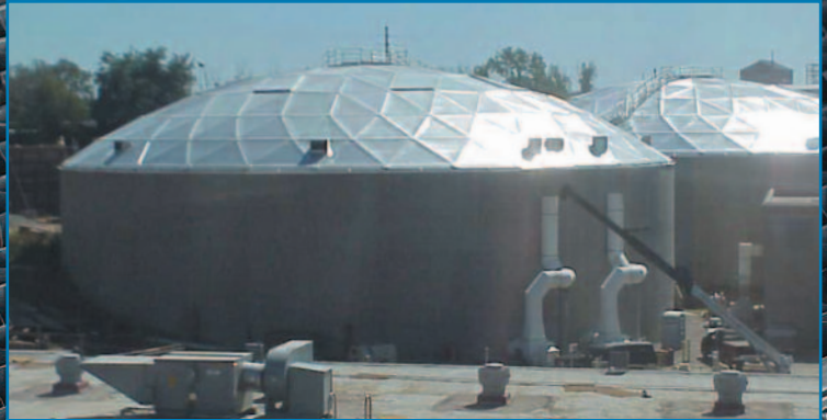
Instalação de meios filtrantes de fluxo vertical AccuPac Morris Forman WWTP, Louisville, KY, EUA
